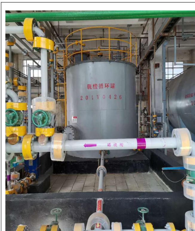
图1 硫酸循环罐及围堰
