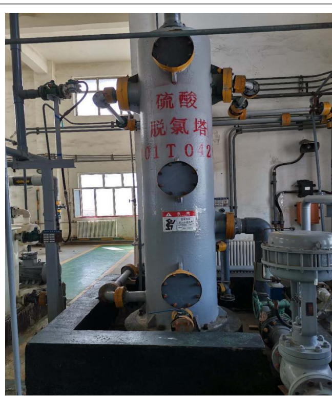
图2 硫酸脱氯塔及围堰
